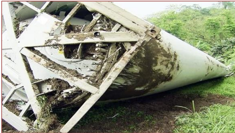
Figura 9 – Tombamento na Rodovia dos Imigrantes
